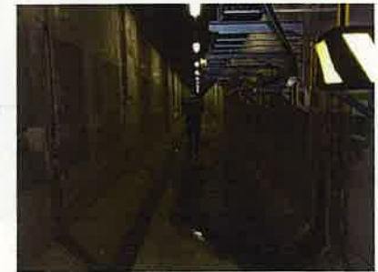
下水管理用施設
