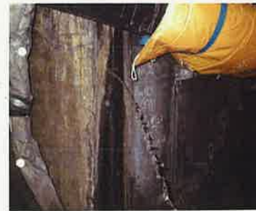
電力地中洞道
