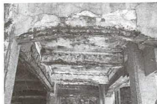
腐食鉄筋の劣化コンクリート
