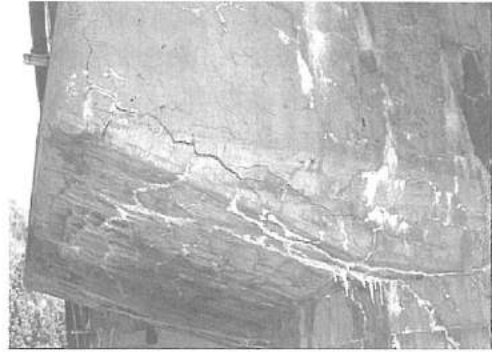
写真1. ASRによる劣化
