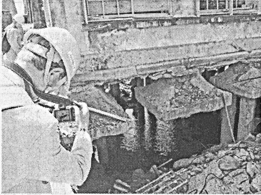
洗掘で杭がなくなった学校
